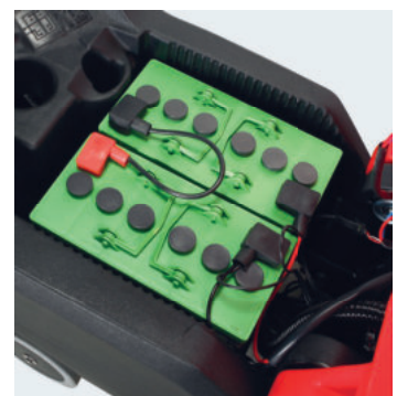
2 x 12 Volt Batteriepack
