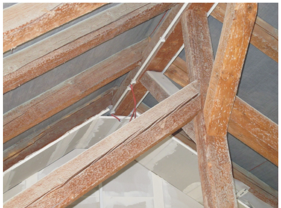
Schimmelpilzbefall im Dachstuhl
